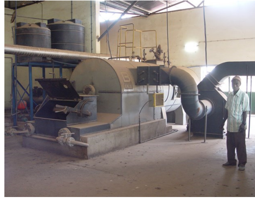
Figura 24: Caldeira de biomassa SICAJU
