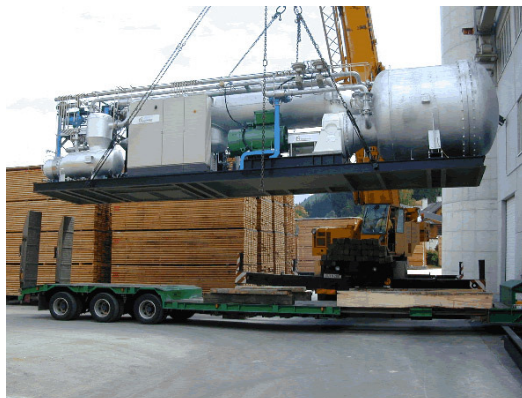
Figura 1: 400 kWe ORC unidade em Admont (Áustria)
