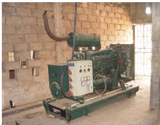
Figura 38: Gerador a Diesel de 100 kVA em ARREY
