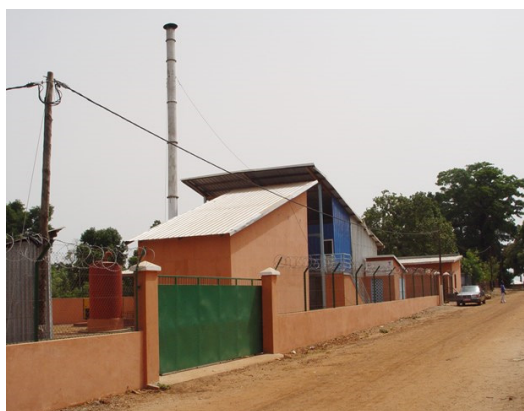
Figura 19: Central elétrica de SAFIM
