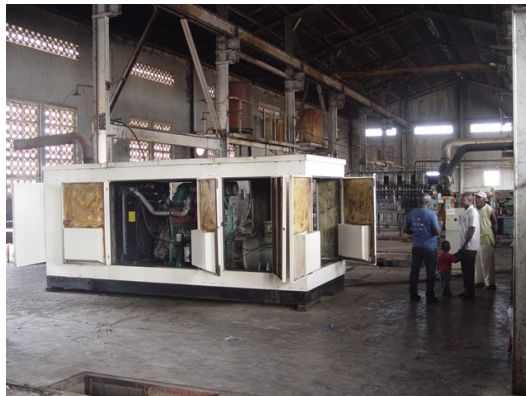
Figura 35: Gerador a Diesel de 450 kVA em Bafatá
