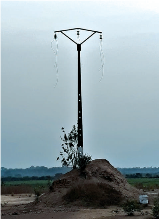
Figura 24 Postes da antiga rede eléctrica em Bafatá, sem fios / Fonte: TESE, 2018
