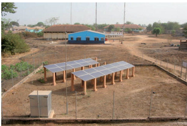
Figura 38 SSBA do projecto BMI no reservatório principal de Bafatá / Fonte: TESE, 2018
