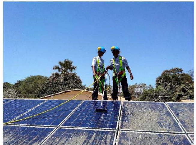
Figure 2 Nettoyage des panneaux photovoltaïques
