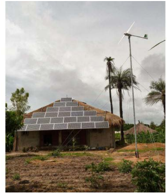
Figure 7 Installation hybride PV-éolienne en Gambie.
