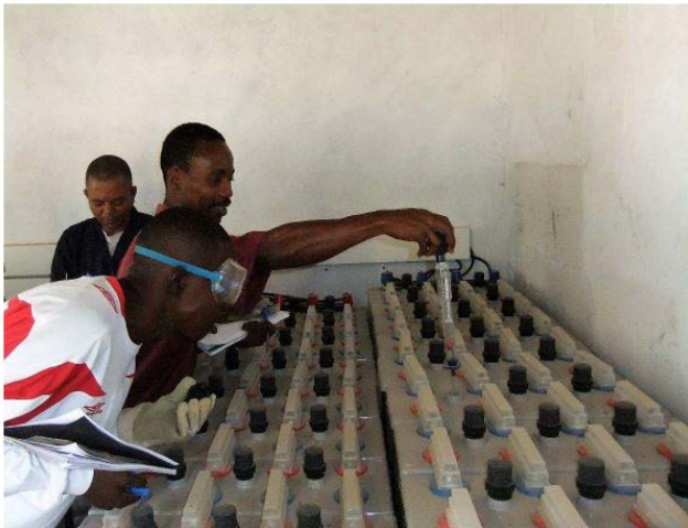
Figure 1 Contrôle de la densité de l'électrolyte des batteries
