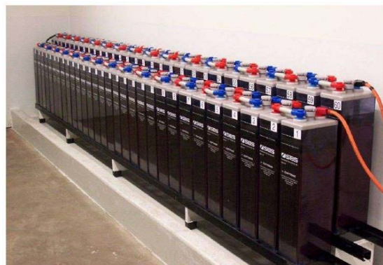
Figure 3 Banc de batteries d'installation photovoltaïque
