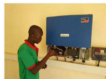
Figure 4 Vérification d'un onduleur photovoltaïque SOURCE: Azimut 360
