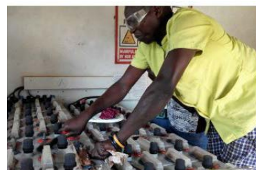
Figure 3 Nettoyage et graissage des bornes des batteries SOURCE: Azimut 360
